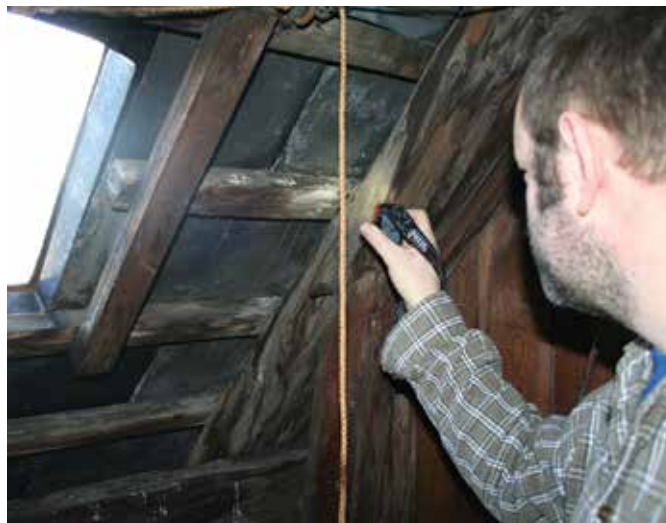
LLOH's byggesagkyndige kommer ud på ejendommen og gennemgår den sammen med bestyrelsen.
