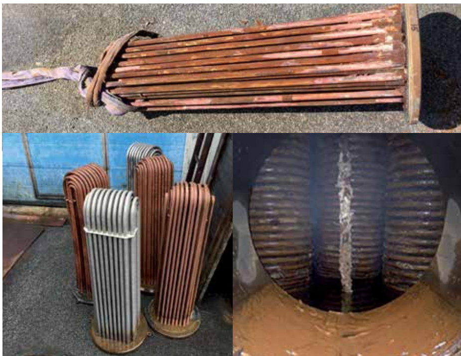
I mange etageejendomme er der gamle varmecentraler, som ikke virker optimalt pga. tilkalkede varmevekslere, udtjente cirkulationspumper og forkert dimensionerede rør. Billederne A og B viser varmelegemer til varmtvandsbeholdere før og efter afsyring. Belægningen øger varmeudgiften kraftigt og lejerne skal betale. Det tredje foto viser en beholder, der ikke har været rensset for kalk i 12 år.
