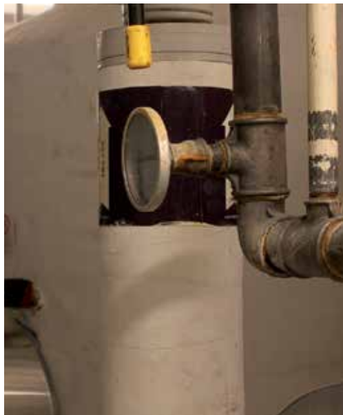
Varmeinstallationerne er en af de steder, hvor der er penge at hente i en vedligeholdelsesplan.
