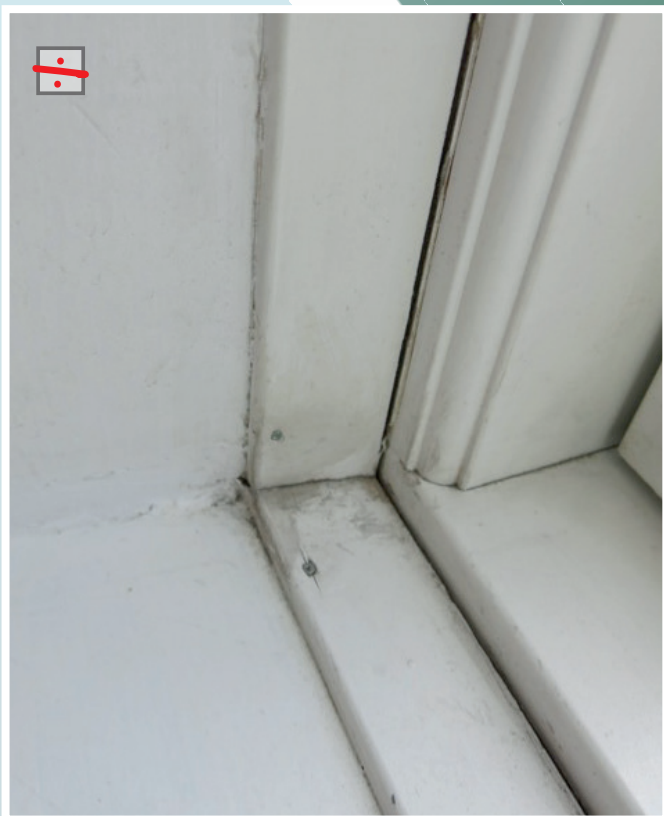
Billede 7: Dårligt udført malerarbejde.
