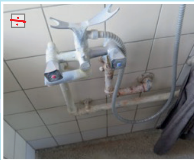
Billede 12: Kalk på blandingsbatteri i bruseniche
