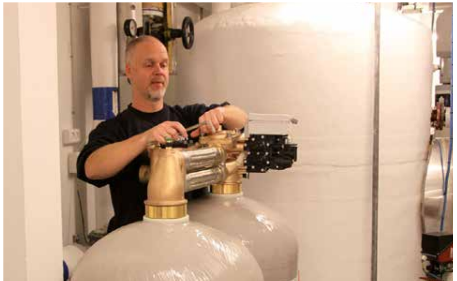
Hverken lejerne eller klimaet kan være tjent med, at varmeanlæggene rundt omkring i landet spilder store mængder energi, fordi de ikke drives optimalt. Her serviceres et blødgøringsanlæg til vand i en velholdt varmecentral på Østerbro. (Arkivfoto).
