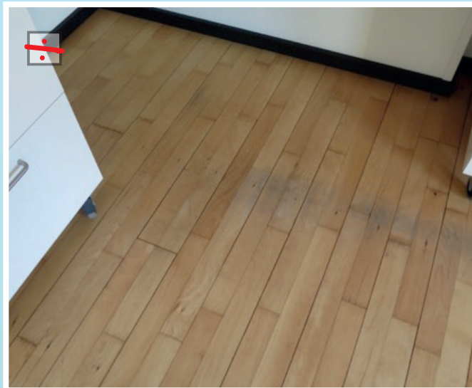
Billede 9: Lakken er gennemslidt og der skal foretages fuld-slibning og lakering inden fraflytning.
