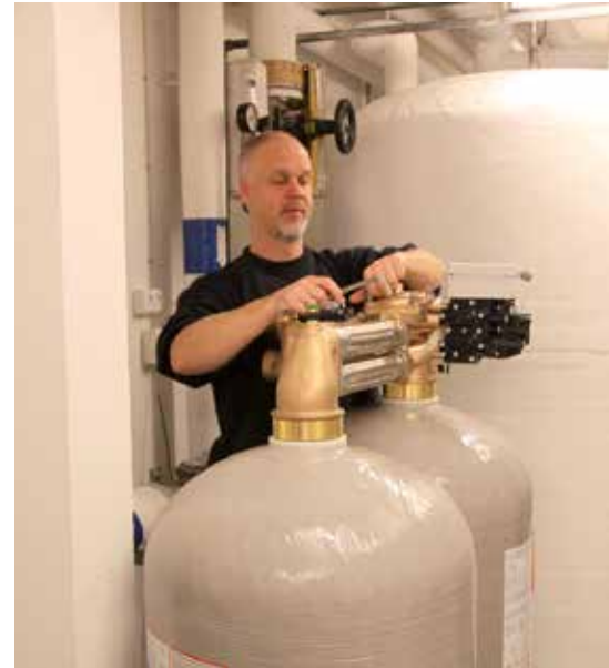
Energispring har fokus på vedligehold og optimering af varmeanlæg, hvilket kan betyde besparelser på mellem 10 og 15 pct.
